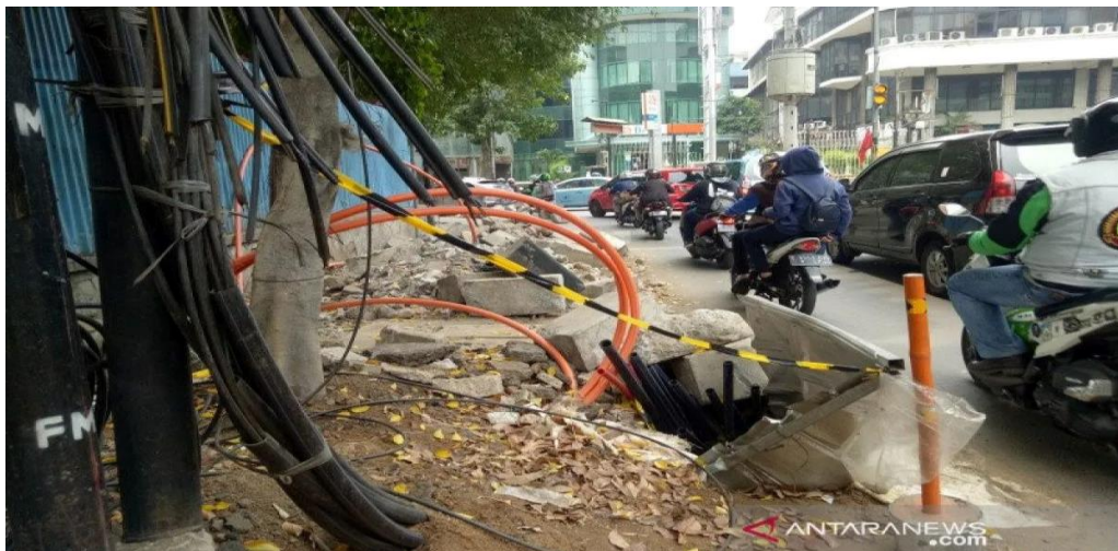
Gambar 1. Contoh Kondisi Kabel Semrawut di Jakarta sumber: antaranews.com
