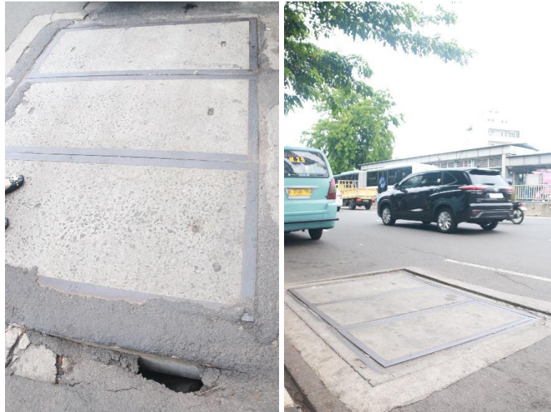
Gambar 5. Kondisi Mainhole yang rusak
