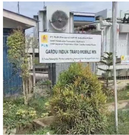
Gardu Induk Trafo Mobile IKN
