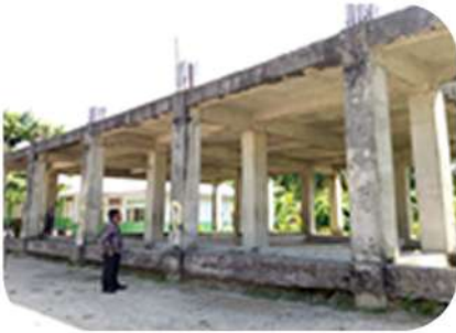
Kondisi Shelter di Ulakan Tapakis yang terhenti dan terbengkalai
